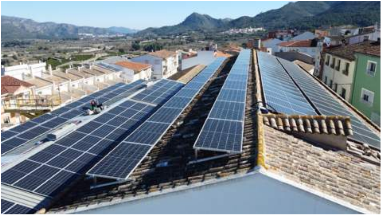
Figura 17: Implantación final de la instalación de autoconsumo colectivo en la cubierta de Agrícola Montitxelvo (Montitxelvo - Valencia).
